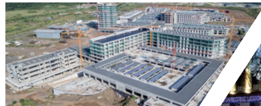
Ciudad de la Salud, Panamá City, Panamá, instalación de climatización. cliente: FCC-presupuesto: 5.000.000 €
